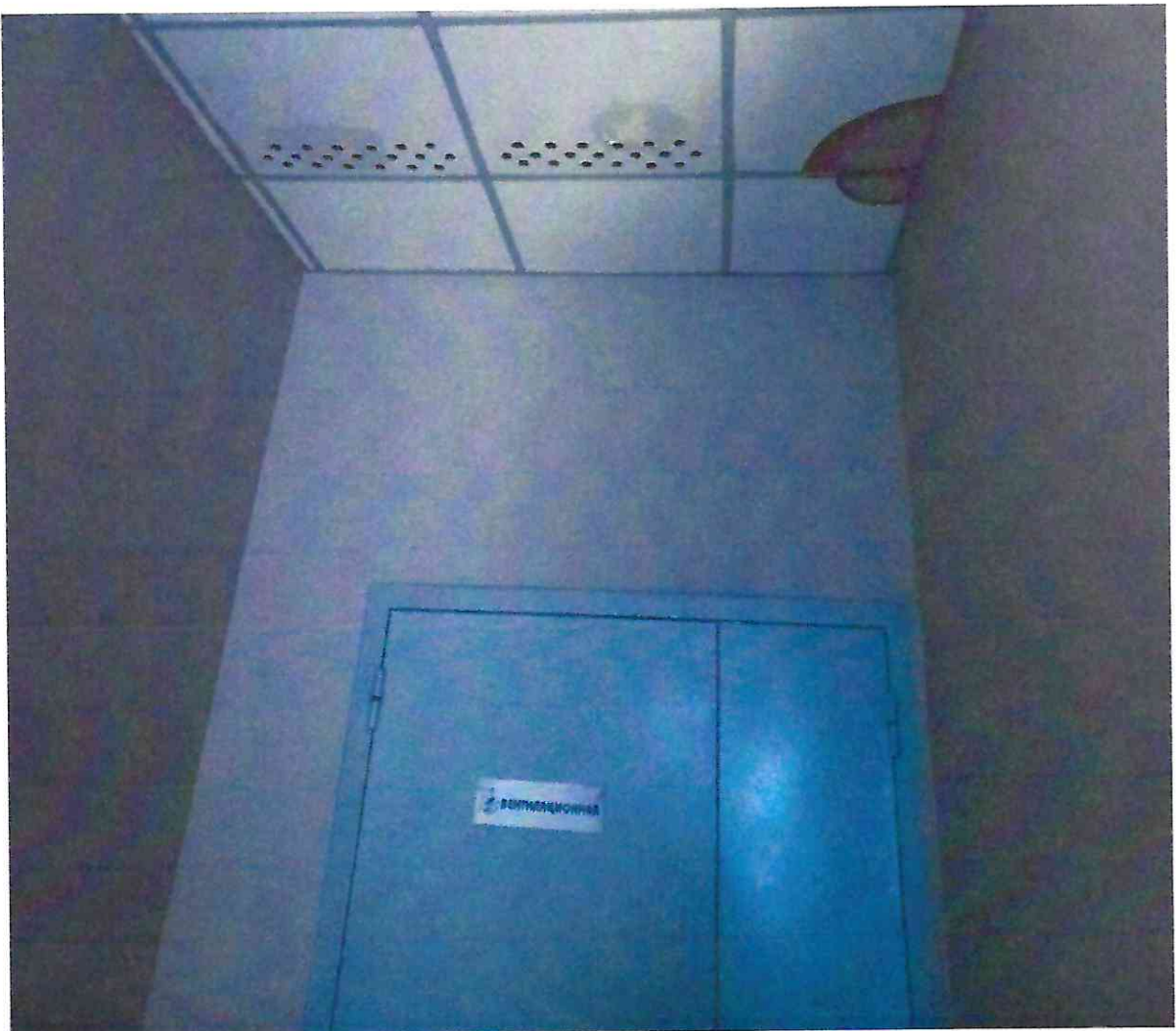
Фото № 48: Образование желтых пятен от протечки на потолке перед входом в вентиляционную камеру.
