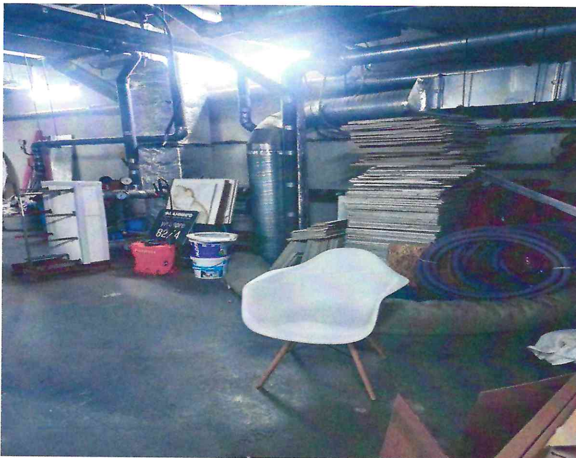
Фото № 49: Вентиляционная камера.
