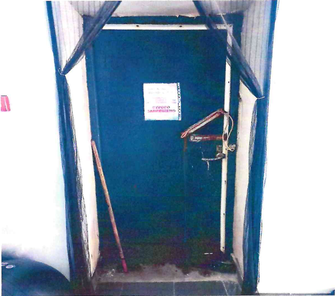
Фото № 55: Образование ржавчины на эвакуационной двери, отслаивание краски и разрушение штукатурного слоя вокруг эвакуационной двери.
