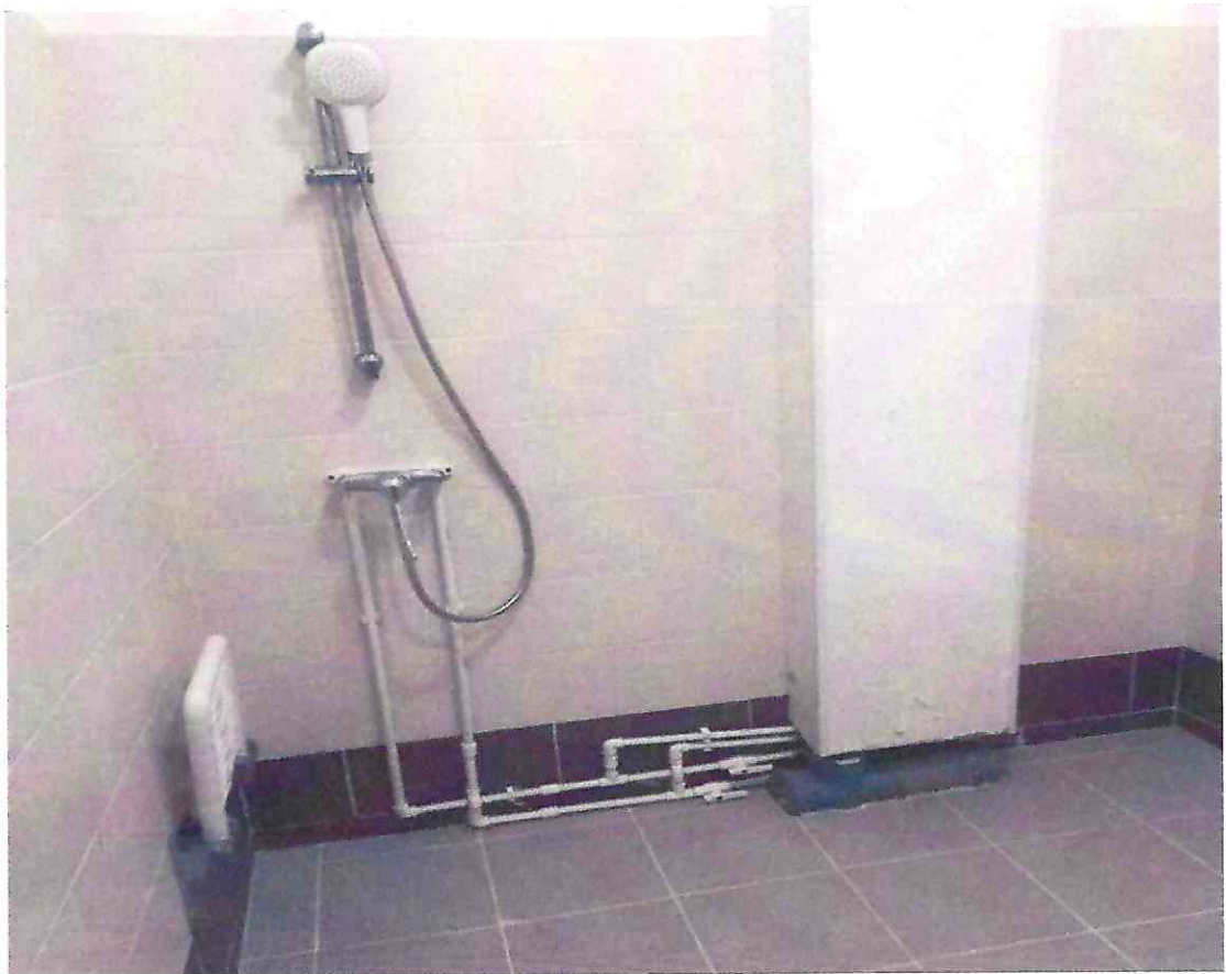
Фото № 26: Отслаивание штукатурного слоя в душевой для маломобильных групп населения.
