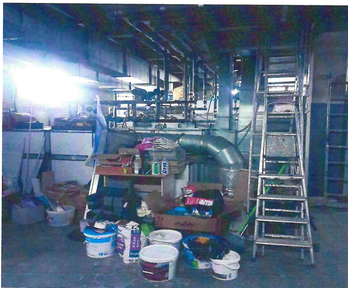
Фото № 50: Вентиляционная камера.
