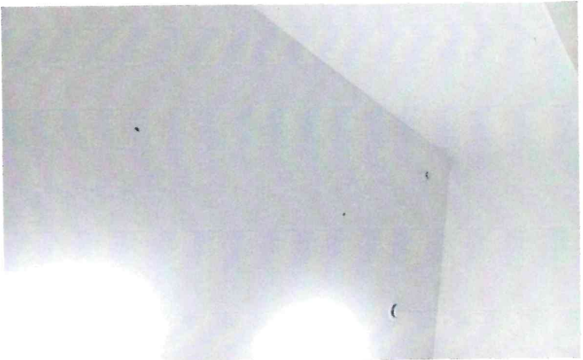
Фото № 20: Повреждения в виде отверстий на потолке в кабинете врача.
