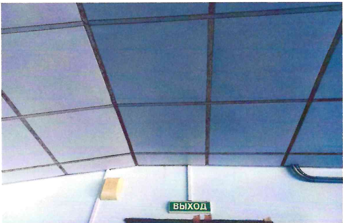
Фото № 56: Образование ржавчины на потолочных плитах Armstrong над трибунами.
