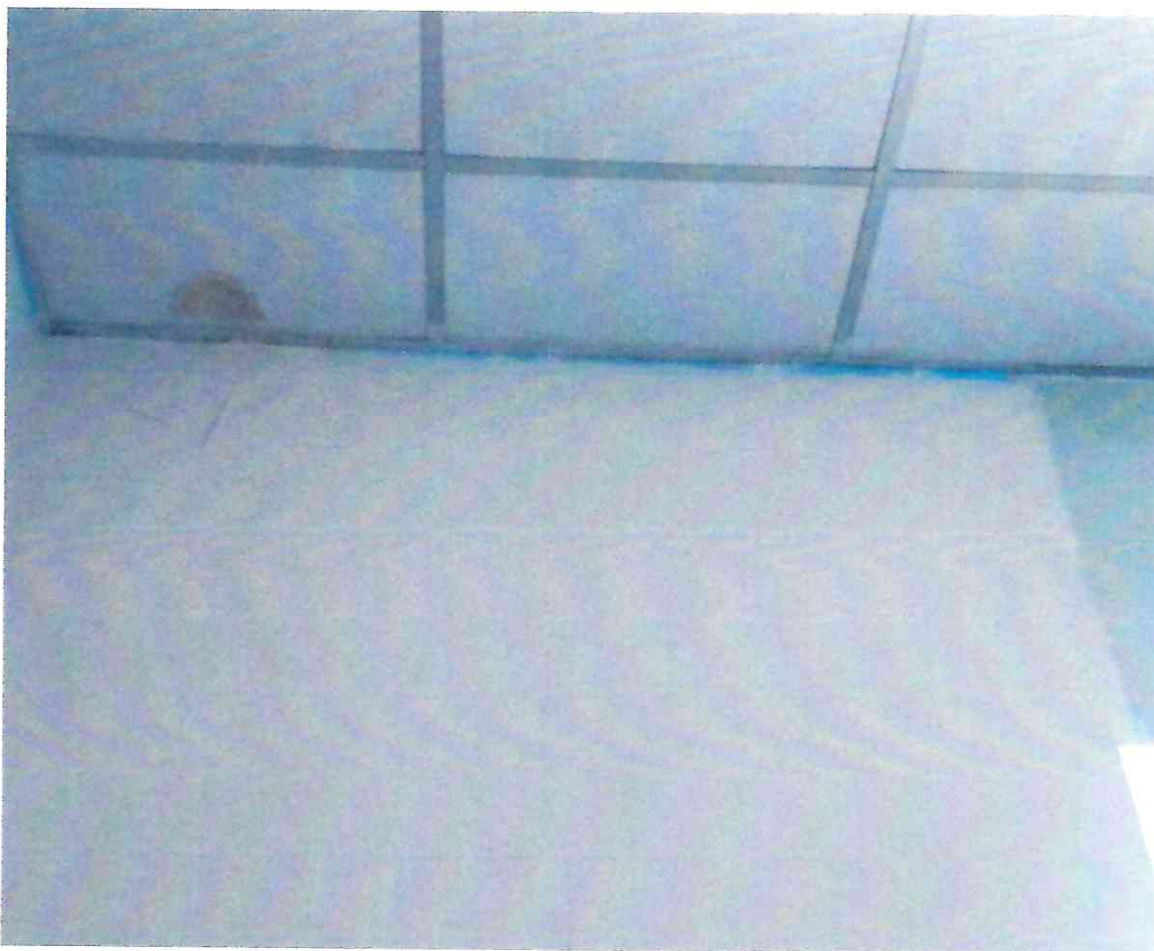
Фото № 41: Образование желтых пятен от протечки на потолке лестничной площадке.
