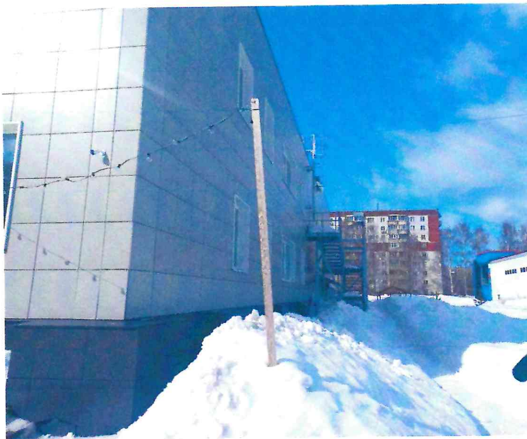
Фото № 3: Отвалы снега вдоль фасада здания.
