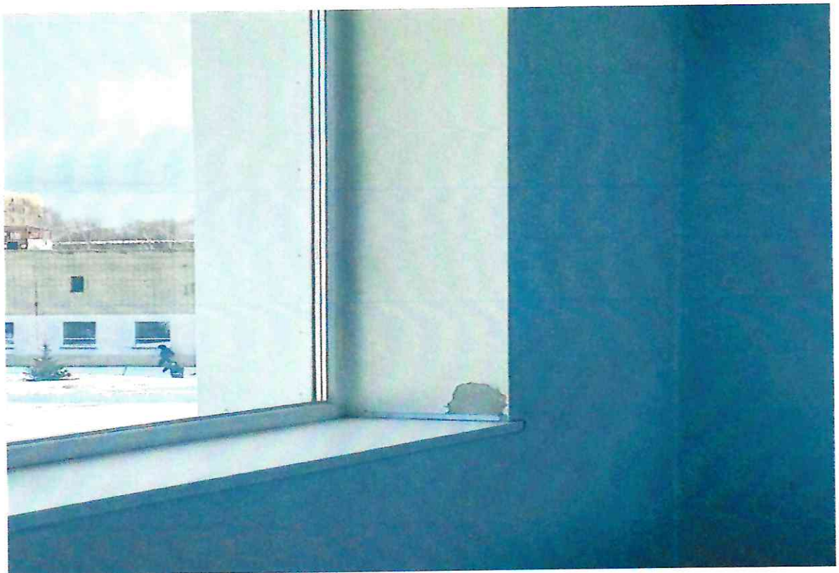
Фото № 40: Разрушение штукатурного слоя на откосе лестничной площадке.
