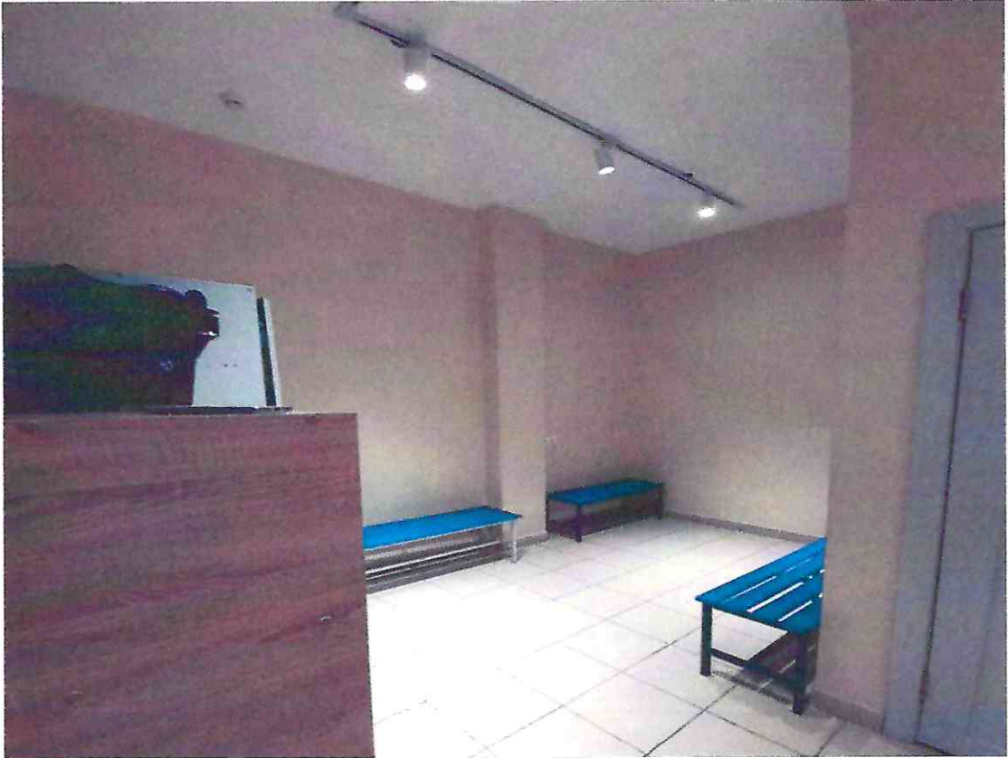
Фото № 32: Повреждение в виде отверстий на потолке в раздевалке.
